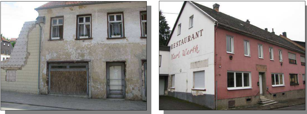
Abb. 23 und Abb. 24: Sanierungsbedürftige Bausubstanz in der Gemeinde Spiesen-Elversberg (ARGUS CONCEPT)
